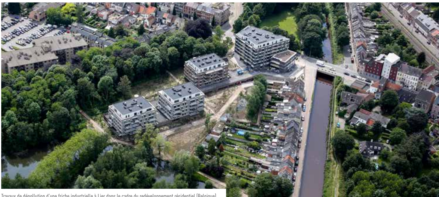
Travaux de dépollution d'une friche industrielle à Liege dans le cadre du redéveloppement résidentiel (Belgique)
