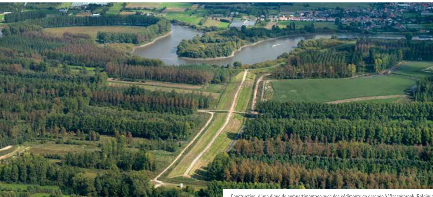
Construction d'une digue de compartimentage avec des sédiments de dragage à Vlassenbroek (Belgique)
